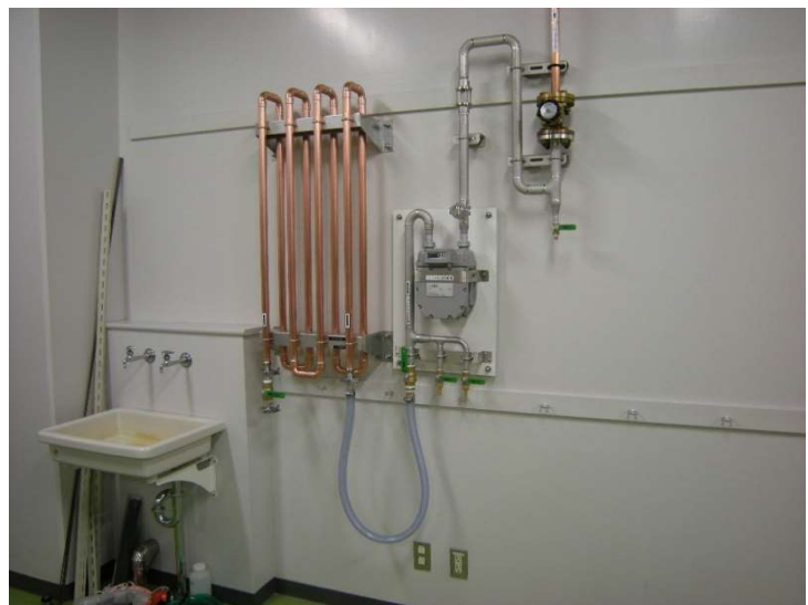
限られたスペースにコンパクトな回収ユニットを設置。
